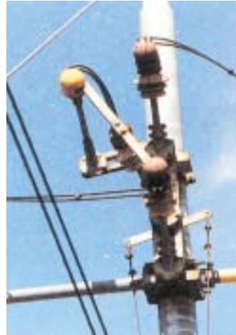
Figura 6: Commutatore in posizione di aperto con collegamento a terra della linea
