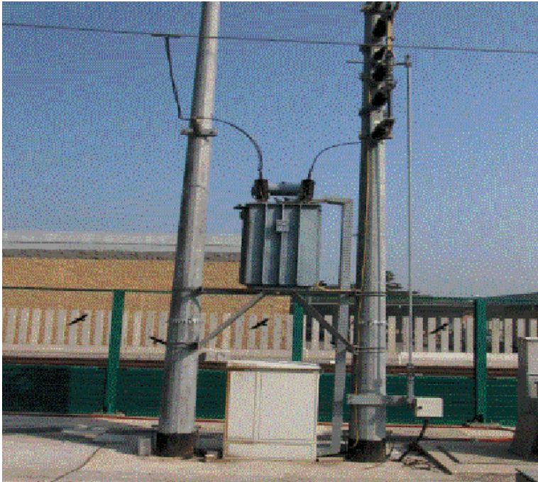
Fig. 3 - Cabina da palo
